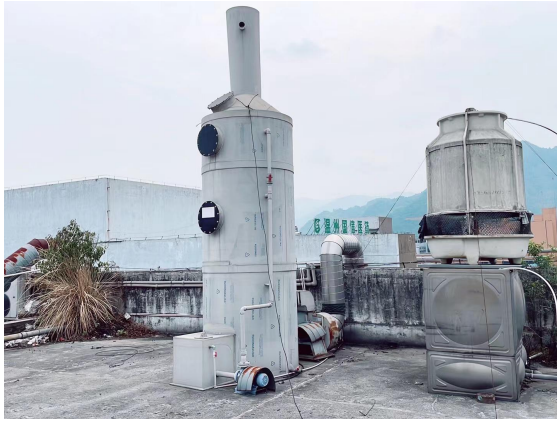
压铸废气处理设施
