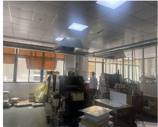
印刷废气收集设施
