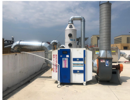
印刷废气处理设施
