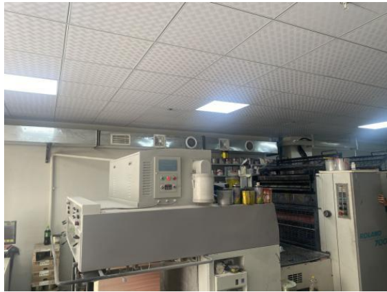
印刷废气收集设施
