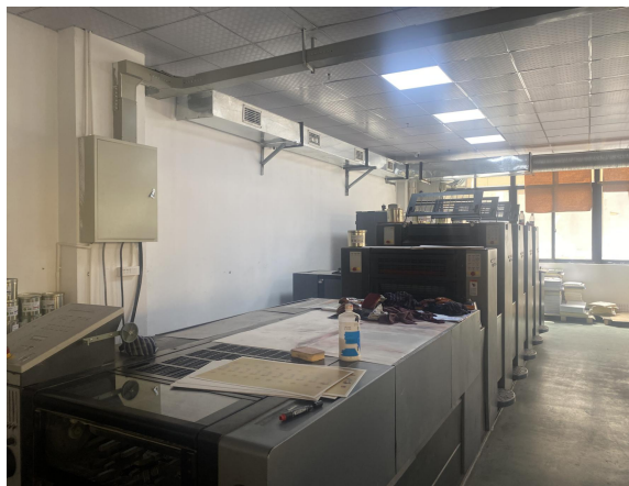
印刷废气收集设施
