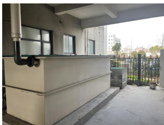
废水处理设施
