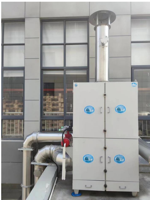
拌料及粉碎粉尘废气处理设施
